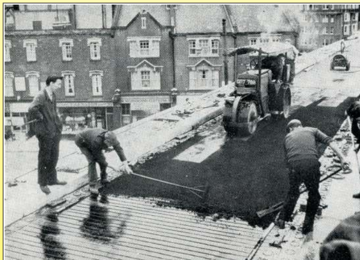
1969 Posa dell'asfalto sulla carreggiata superiore di un incrocio Hammerschmidt a Londra (Electric heating of the roadways, by Robert Félix, 1971, Ultimheat Museum*)
