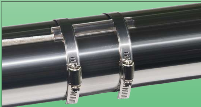
Esempio del modello del sensore di temperatura dopo l'installazione
